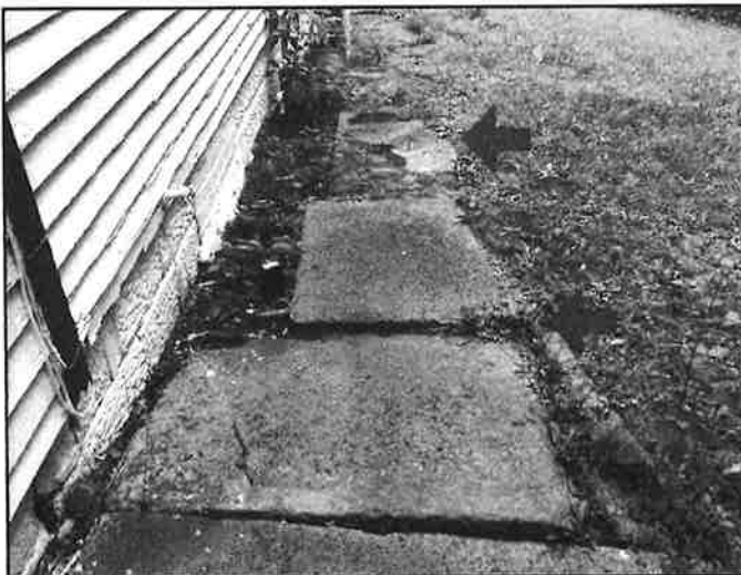
127. Uneven (trip hazard)
