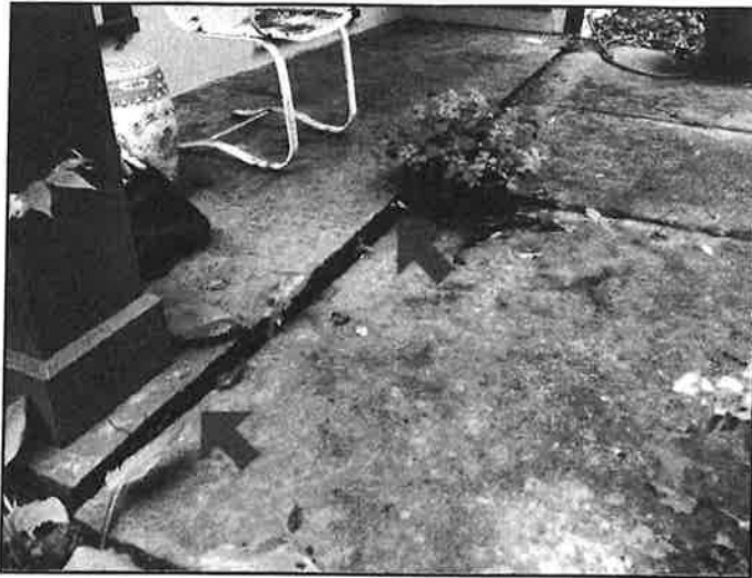
23. Uneven (trip hazard)
