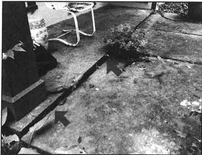
131. Uneven (trip hazard)
