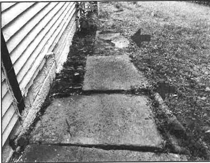
19. Uneven (trip hazard)
