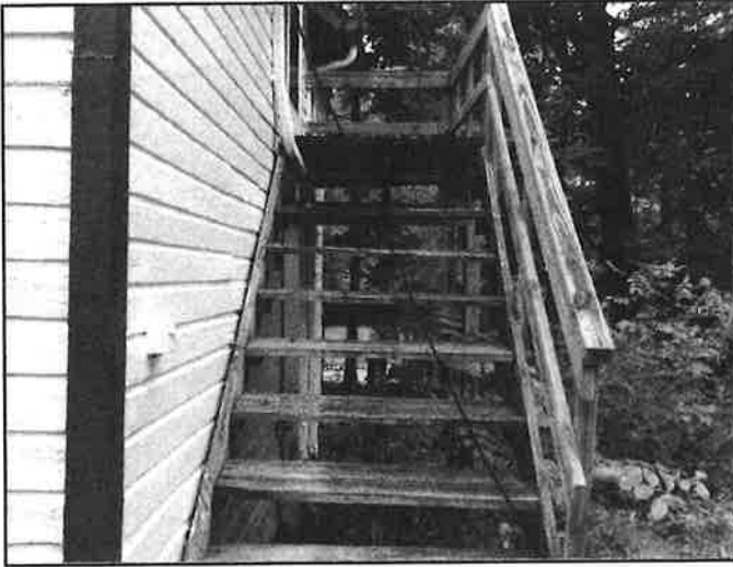
27. Loose Steps / Rot
