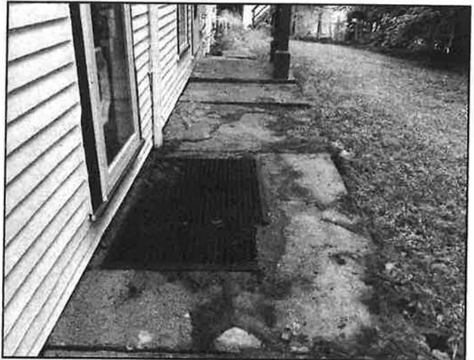
26. Uneven (trip hazard)
