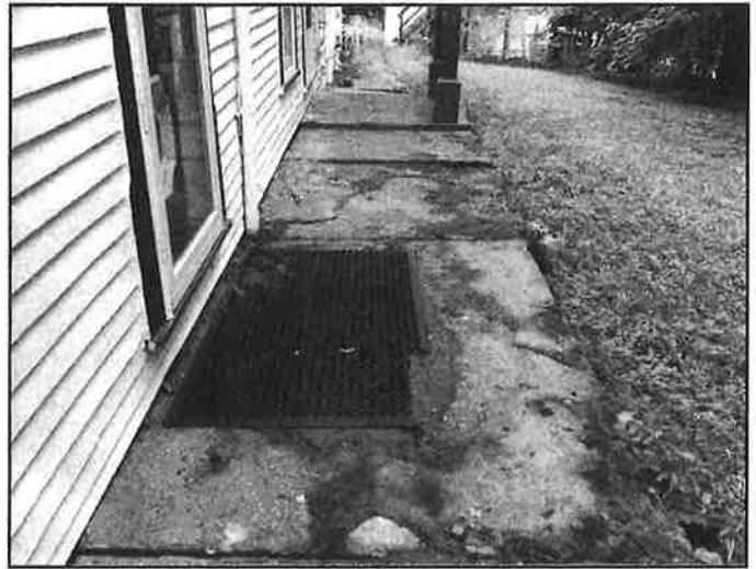
134. Uneven (trip hazard)
